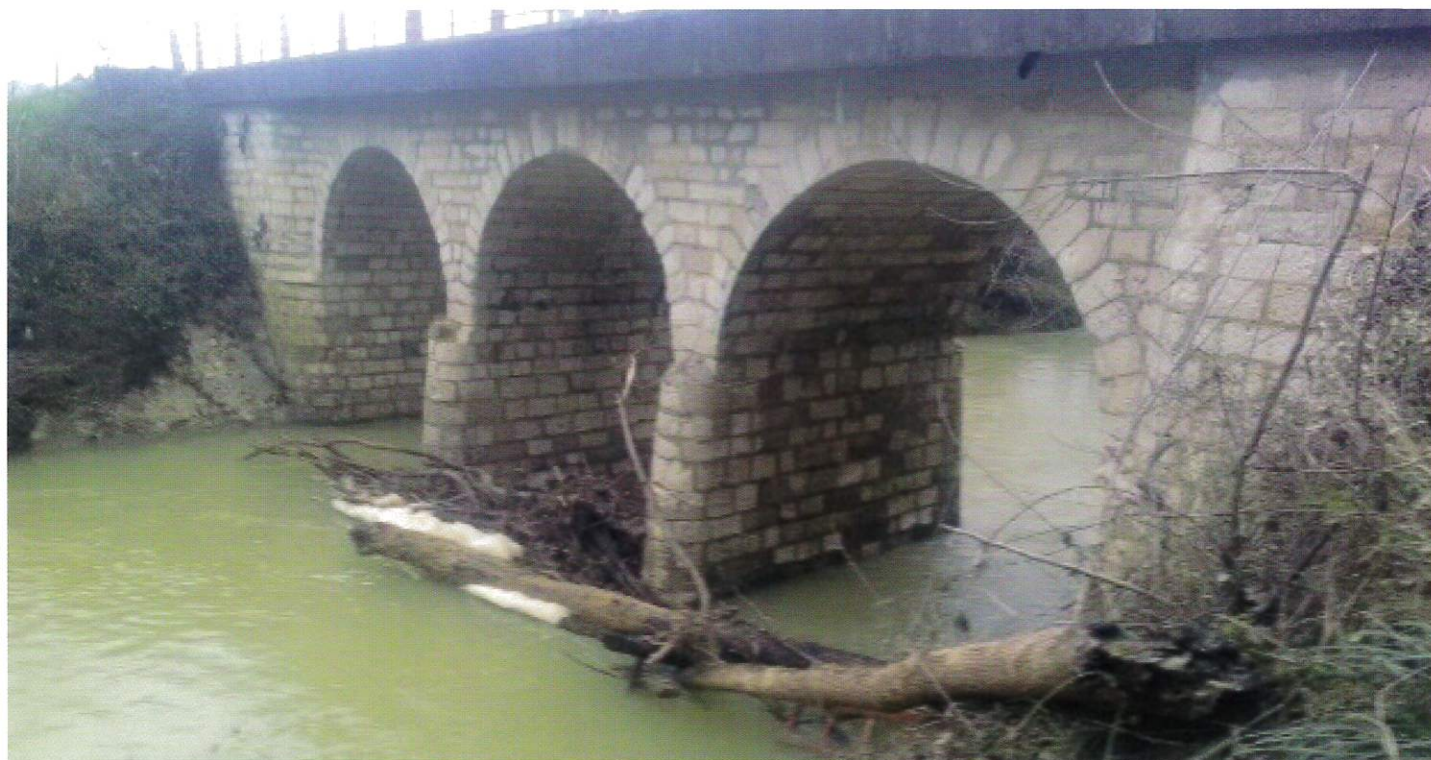
Photographie d'un embâcle au Pont du GERS à GOULENS.
